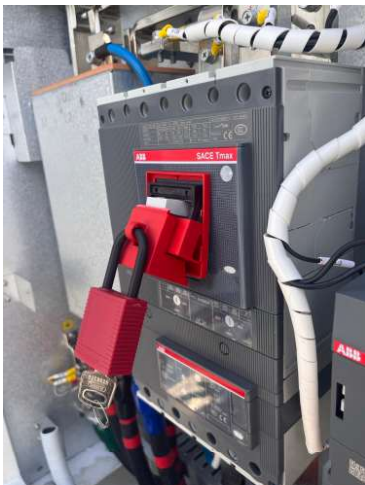
Abbildung 24. Aufschließen des Leistungsschalters
