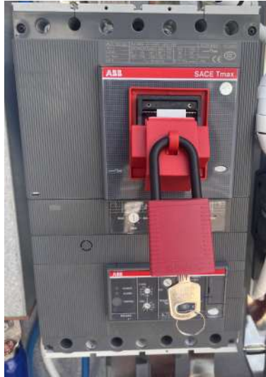
Figura 23. Desbloqueo del interruptor
