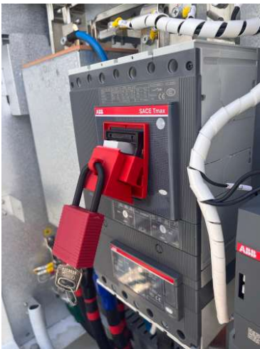
Figura 24. Desbloqueo del interruptor
