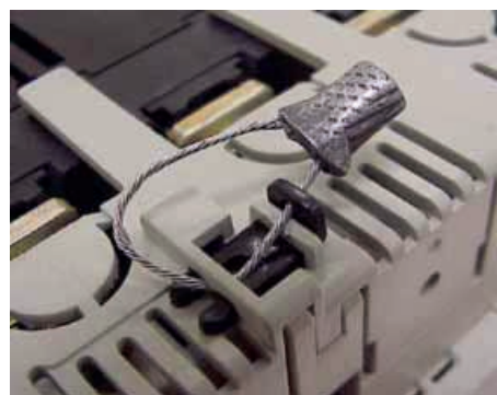
Tapas de terminales con dispositivo de cierre y precinto
